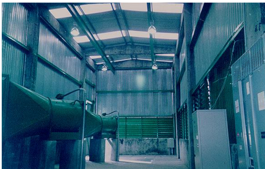
FERROSUR. Sistema de ventilación del túnel "El Mexicano".
