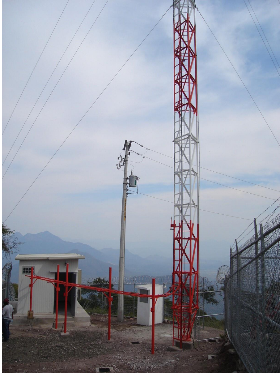
KCSM. Torre de telecomunicaciones
