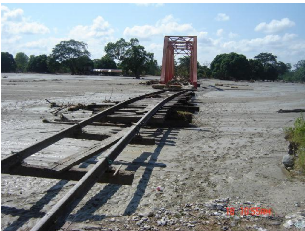
CFCM. Vía destruida por el huracán Stan
