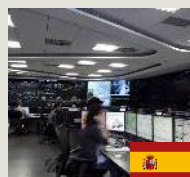
Comunic. fijas red AV Red de com. fijas del AVE Valladolid-León-Burgos y Extremadura
