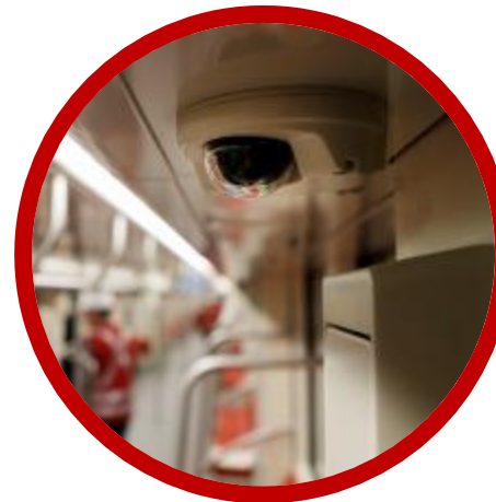
Cámaras de Seguridad en Trenes
