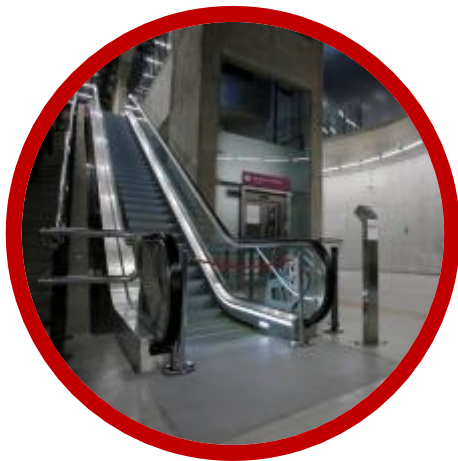
Escaleras Mecánicas y Ascensores en todas las Estaciones
